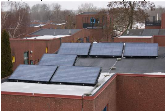
Solcellerne gør Høkerlængen 2 til et Plus-energi-hus
